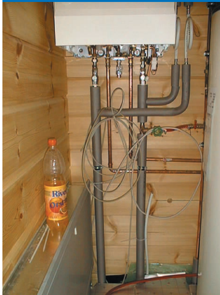
Die Zuleitungen zur Gastherme führen geradewegs aufwärts, die Verlegung in einer Schleife wäre erforderlich.
