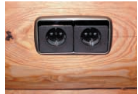
Elektroinstallation am Naturstamm.
