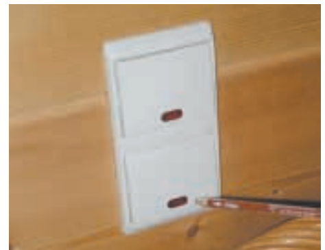
Der Schalter wurde nicht mittig auf den Blockbalken ausgerichtet und zudem nicht abgedichtet.
