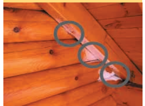
Bild 2: Durch die Undichtigkeit kommt es zur gefrierenden Kondensation.
