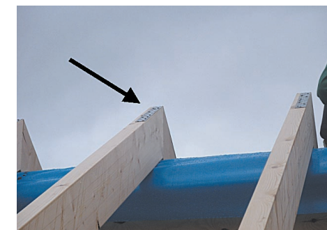
Ein 50 cm langes, voll ausgenageltes Windrispenband reicht meistens aus, um die Zugkräfte am First aufzunehmen.
