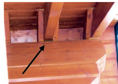
An der Auflage der Dachsparren fehlt eine Befestigung, die zugleich kraftschlüssig und zugfest verankert ist.
