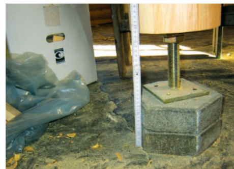
Selbst bei einer relativen Holzfeuchte von 20% gilt es, fast 5 cm Setzung zu berücksichtigen.
