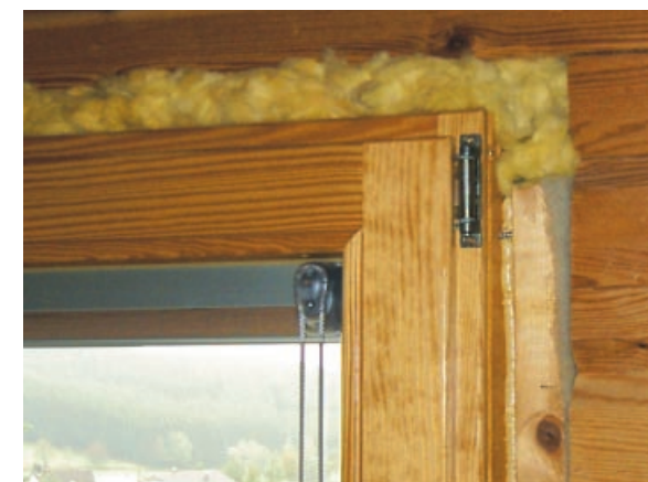
An diesem Beispiel ist zu erkennen, dass zuviel Dämmung eingebaut wurde.
