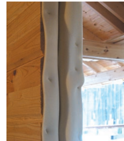
Ein schlagregendichtes Dichtband wird in den Türdurchbruch eingelegt. Danach erfolgt das Einpressen der Rutschleiste und später die Montage der Türzarge.
